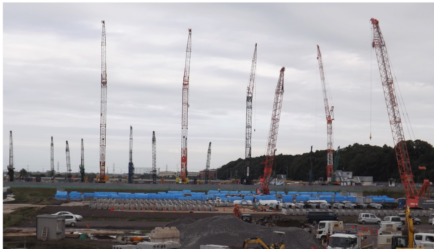
クレーン車が乱立し、大型物流センターの建設工事が実施されている新川耕地。高速から見られた斜面緑地も見納めです
