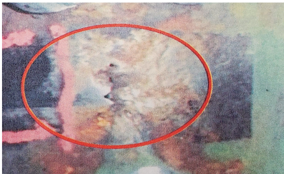
炉の周りに設置されている水管（ボイラー）の損傷（黒点）。必要な熱回収に支障をきたすことから、「炉停止」が求められました。
