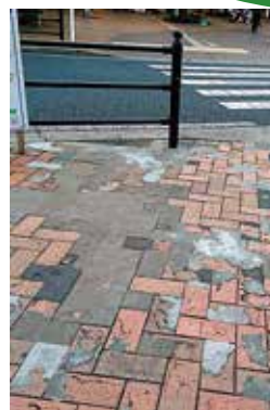
美観は…。まずはタイルの 応急措置（江戸川台駅東口） 植田和子
