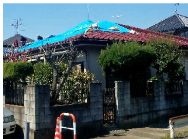
ブルーシートが敷かれた家屋
